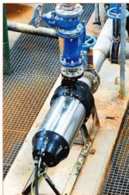
Най-новата апаратура и съвременните технологии за автоматизиране осигуряват ефективна работа на пречиствателните станции на „Асарел-Медет“
