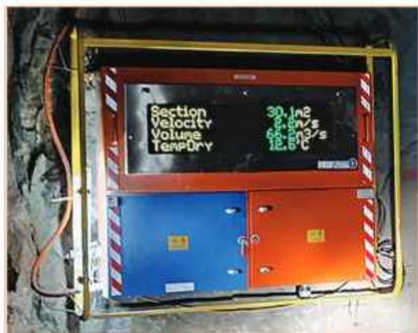
Дигитална измервателна станция в рудника
